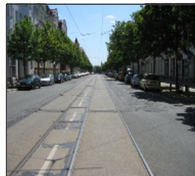
Unsanierter Abschnitt Landsberger Straße
